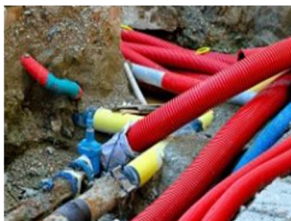
地下管线泄漏
